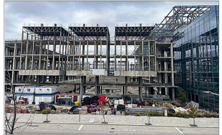
La infraestructura inacabada del Centro Acuático. JAVIER BARBANCHO
